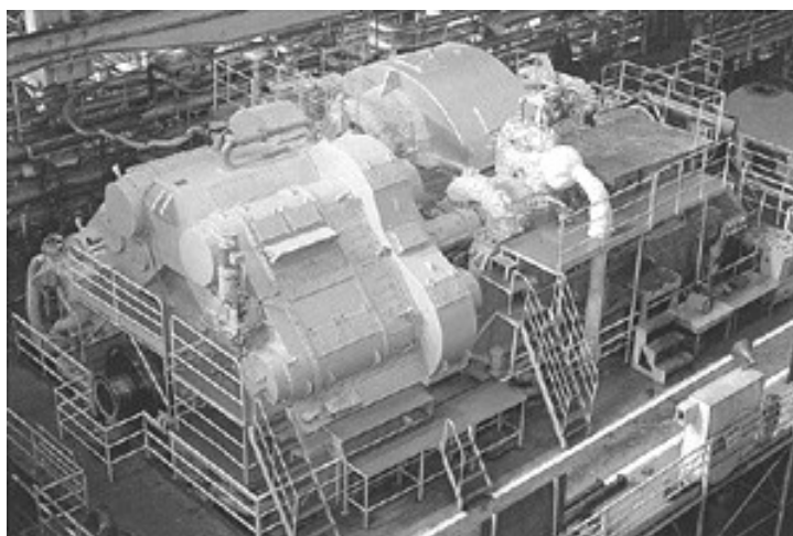
Rys. 1. Okrętowy turbozespół parowy napędu głównego typu MS-2 Mitsubishi Heavy Industries Ltd. [12]
