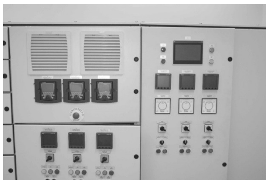
Rys. 5. Nowoczesna rozdzielnica 0,4 kV z polami synchronizacji prądnic klatkowej, pierścieniowej i synchronicznej
